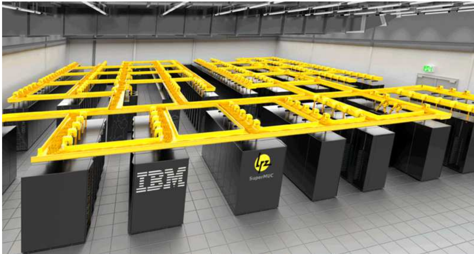
SuperMUC-NG, Leibniz Rechenzentrum, Germany
