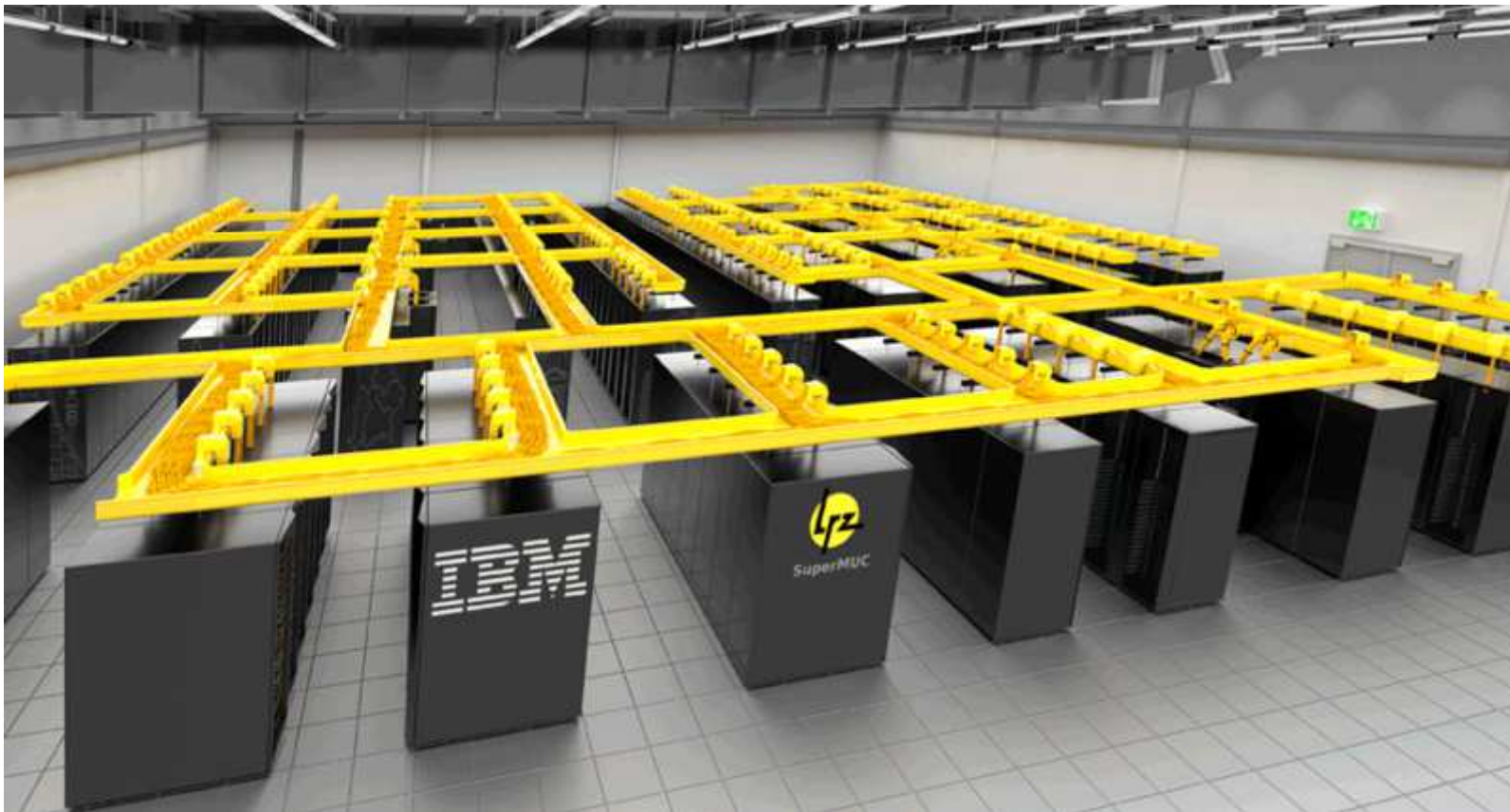
SuperMUC-NG, Leibniz Rechenzentrum, Germany
