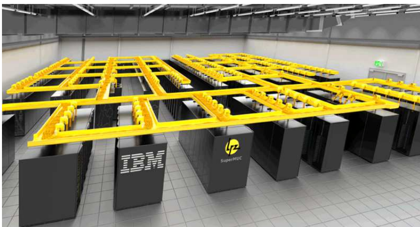
SuperMUC-NG, Leibniz Rechenzentrum, Germany
