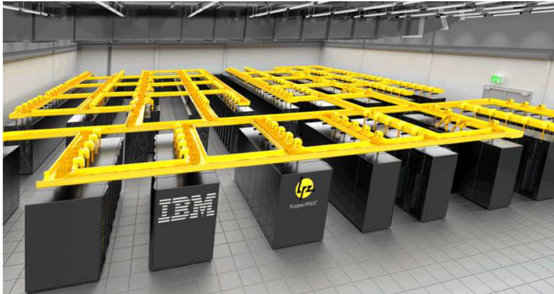
SuperMUC-NG, Leibniz Rechenzentrum, Germany
